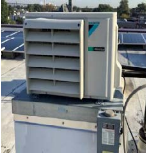
Server Room C300C Ductless Mini Split HP
