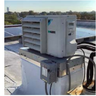
Server Room C100C Ductless Mini Split HP
