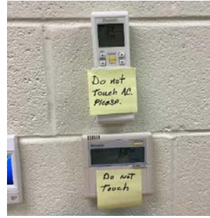
ECC Ductless Mini Split Local Controls
